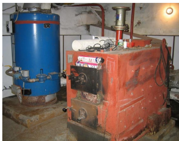
Rys. 2. Kotłownia szkolna – kocioł gazowy o mocy cieplnej 145 kW i kocioł węglowy
