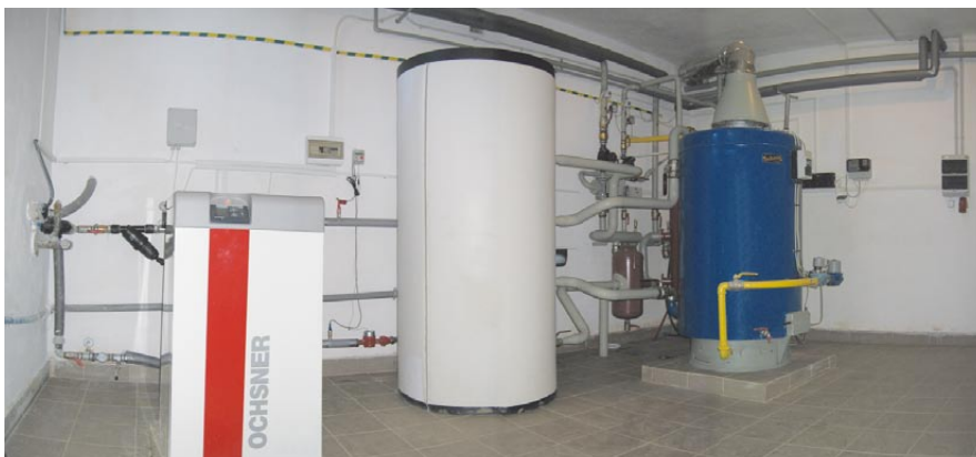
Rys. 4. Zmontowany system grzewczy – pompa ciepła, zbiornik buforowy, rozdzielnia elektryczna, instalacja wodna
